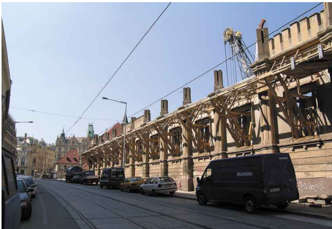
6. Unikátní krov jízdrny Josefských kasáren v ulici Na Poříčí, chráněné stavební památky, byl sňat se zdůvodněním, že je to pro jeho restaurování nezbytné. Ve skutečnosti překážel mohutným stavebním pracím v objektu samém a v jeho bezprostředním okolí. Foto K. Bečková, 2005
