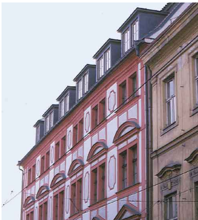
18. Malá Strana, Windischgrätzovský palác čp. 119 s novými megalomanskými vikýři. Problém je nejen v jejich počtu, velikosti a podřadném řemeslném zpracování, ale i v jejich kontrastní černé barvě dané užitím měděného plechu.
