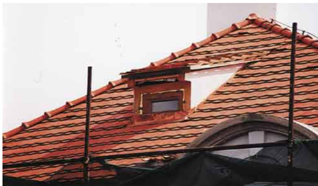
3. Malá Strana, snímek ilustruje následky ztráty citu pro architekturu a krásu konstrukce. Vikýř není rozměrově větší než jeho historičtí předchůdci, ale jeho konstrukce je nepochopená a proto nezvládnutá. Jedná se přitom o střechu, která leží v horizontu chodců kráčejících po Karlově mostě, tedy pohledově mimořádně exponovanou.
