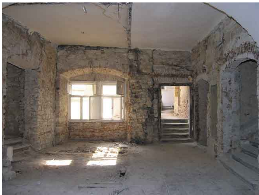
11. Staré Město, dům čp. 234 mezi Jilskou a Jalovcovou ulicí. Interiér domu po otlučení historických omítek a dalších nepovolených zásazích. Foto M. Patrný, 2004
