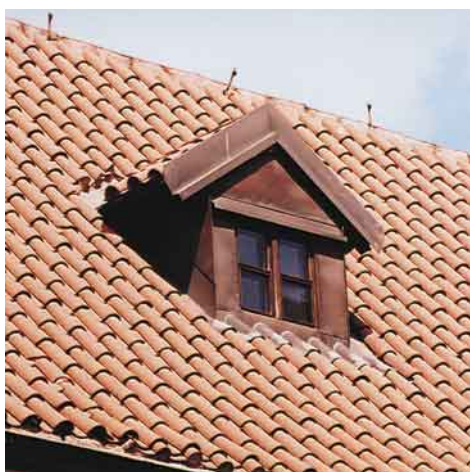
7. Hradčany, ilustrace utilitárního přístupu ke střešnímu vikýři. Je až nepochopitelné, jak mohl někdo udělat něco tak ošklivého a řemeslně nezvládnutého.
