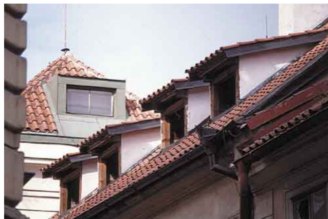
9. Malá Strana, nové utilitární vikýře hyzdící vzhled malostranské střechy.
