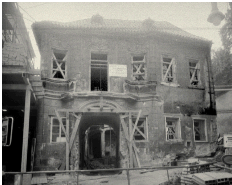
1. Malá Strana. Dům U Ježíška na Tržišti v zimě roku 1992. Příprava objektu pro plánovanou rekonstrukci znamenala likvidaci většiny autentické výbavy domu – oken, dveří, podlah, stropů atp. Od té doby udělala péče o památky velký krok kupředu, přesto o podobné obrázky není ani dnes v centru Prahy nouze.
