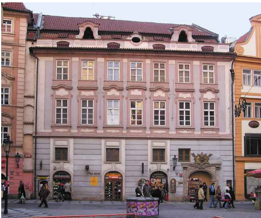
7. Staré Město. Průčelí domu U Sixtů čp. 553 v Celetné ulici nenasvědčuje tomu, že se za ním skrývá vykuchaný a těžce poškozený objekt. Foto R. Biegel, 2003
