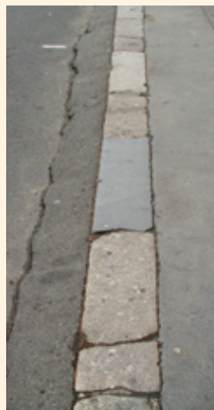
Nevhodnou neodbornou manipulací jsou obrubníky často otlučeny a polámaný a mnohdy jsou navíc následně necitlivě opraveny betonem.
