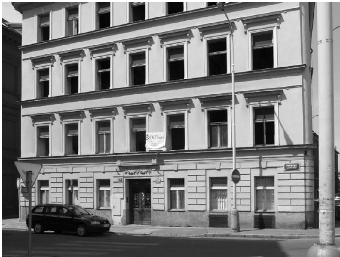
Okna domu jsou dlouhodobě otevřena či vysazena.
